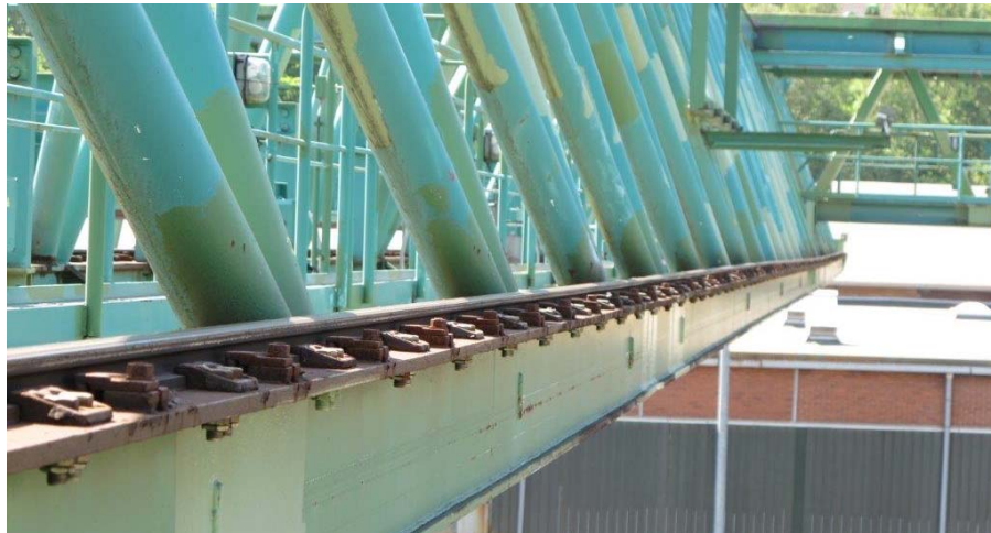
Kranschiene vor der Instandsetzung
